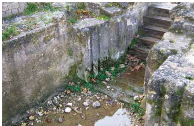
Vannes de réglage au bassin régulateur © Jean-Christophe GALANT
